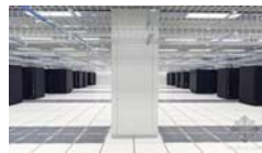
上海杨桥数据中心 19XR-2000RT*8/-1600RT*4
